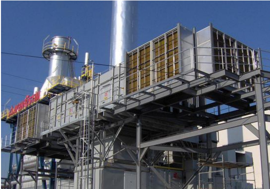
Resim.2- Türbin Giriş Hava Soğutma Ünitesi Uygulama Örneği
