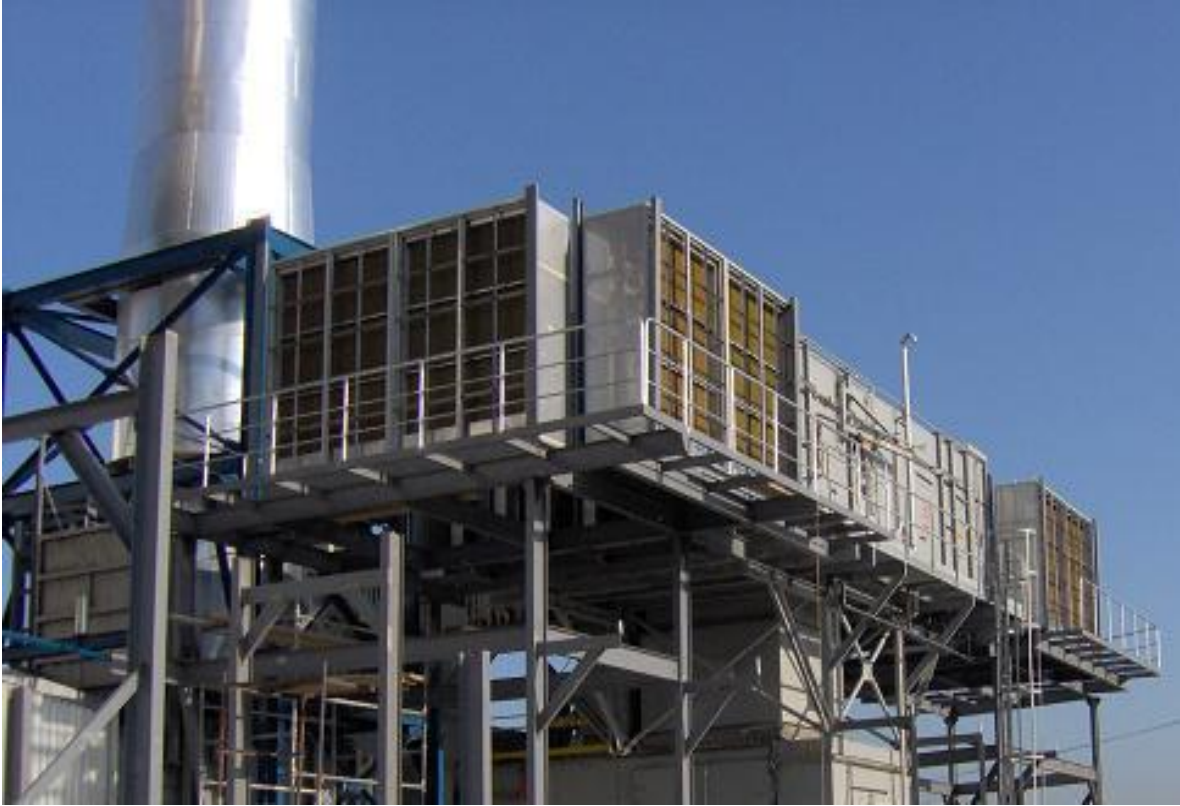
Resim 3- Türbin Giriş Havası Soğutma Ünitesi Uygulama Örneği
