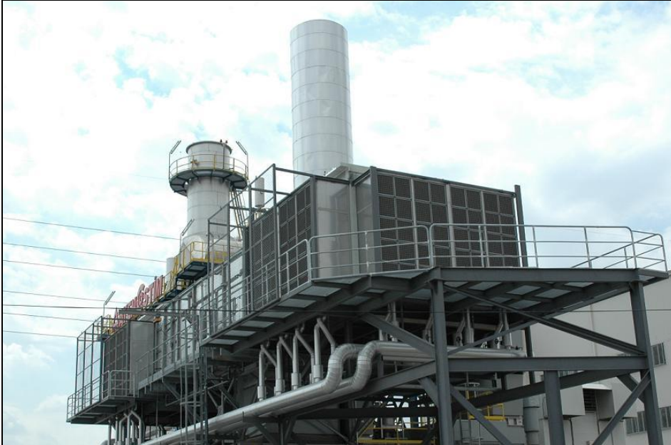
Resim.2- Türbin Giriş Havası Soğutma Ünitesi Uygulama Örneği
