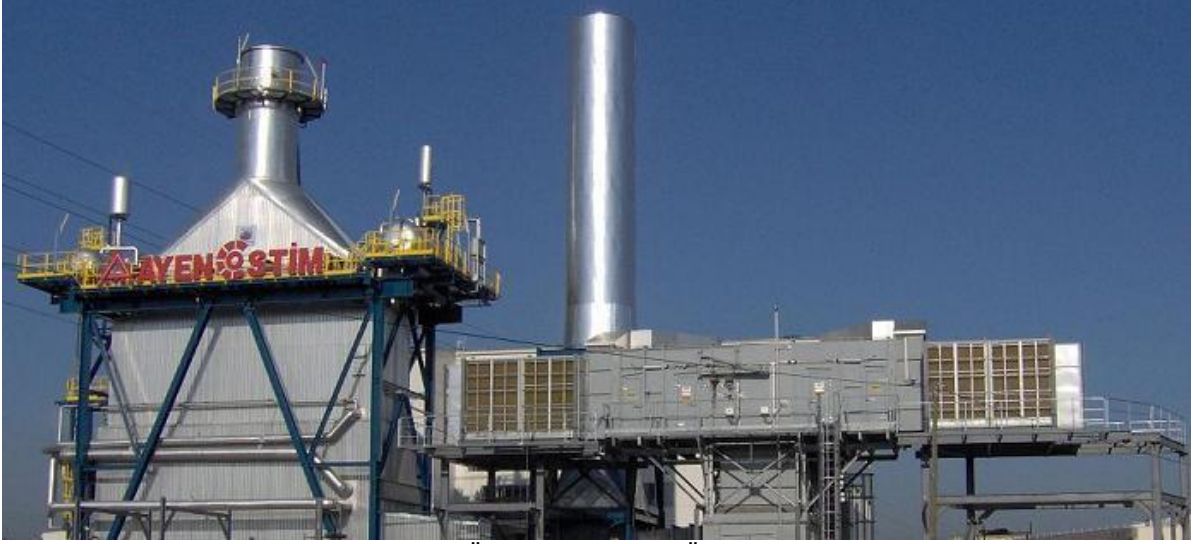
Resim.1- Türbin Giriş Havası Soğutma Ünitesi Uygulama Örneği
